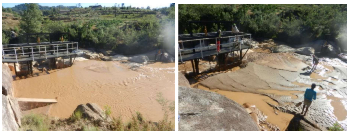
Photo 3: Ensablement du barrage de Fandriana
