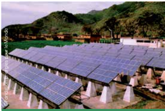
Centrale solaire de Kankoy (Pakistan) - 70 kWc.
