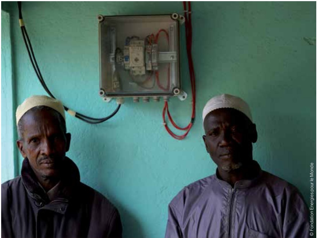
Interface client installée dans le cadre du projet Pehgui, en Guinée.
