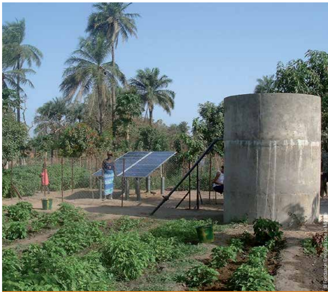
Pompe solaire dans un périmètre maraîcher au Sénégal, projet Essen 2.
