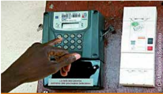
Exemple de compteur utilisé pour le prépaiement de l'électricité
