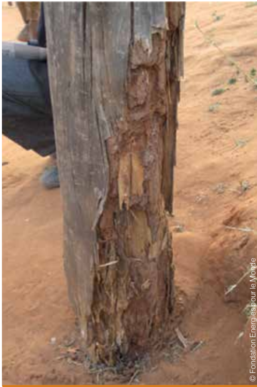
Poteau dont le bois est pourri.
