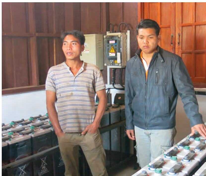
Les deux techniciens en charge de la centrale solaire.
