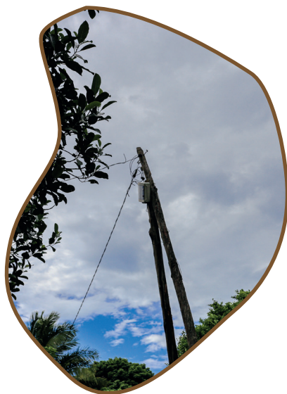
Ligne de distribution basse tension.
